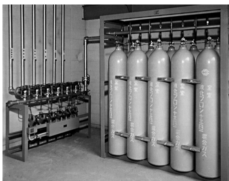
図1 ハロン 1301 消火設備のボンベ
